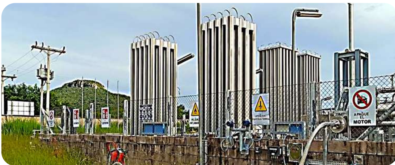
Supervisión a la Estación de Regasificación
