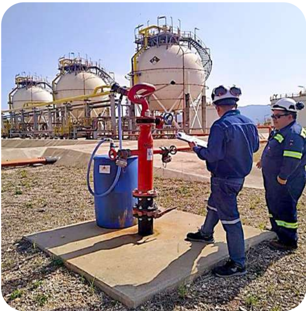
Supervisión a la Planta Separadora de Líquidos Carlos Villegas
