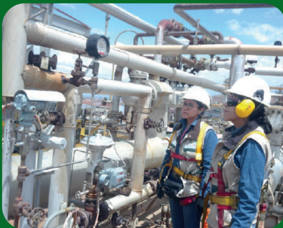
Imagen N° 3: Refinería Gualberto Villarroel - Condiciones de Operación - Planta de Lubricantes - Área MEK TOLUENO
