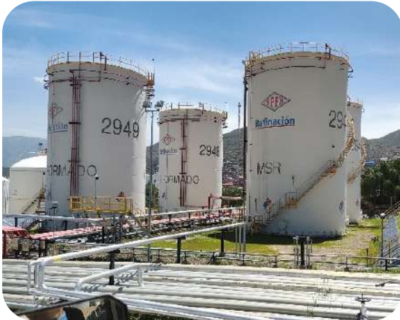
Imagen N°5: Refinería Gualberto Villarroel - Almacenaje Productos Intermedios
