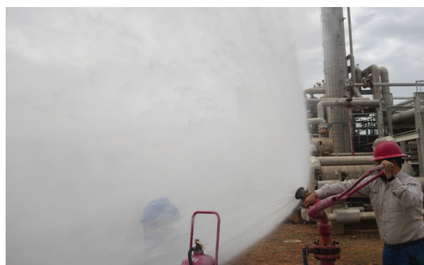
Imagen N° 8: RON – Almacenaje GLP
