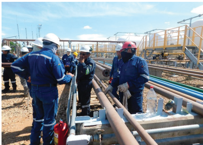
Imagen N° 1: LÍNEA DE MEDICIÓN DE GLP – PLANTA DE SEPARACIÓN DE LÍQUIDOS RÍO GRANDE
