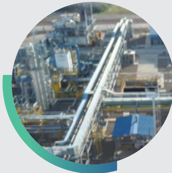
Planta de Gas Natural Licuado de Rio Grande
