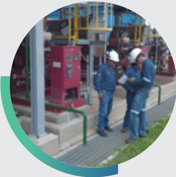
Supervisión a la Seguridad - Red contra incendio.
