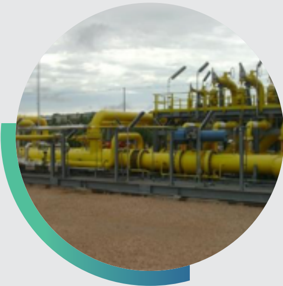
PSLCV, ducto de Entrada Gas Natural y Salida de Gas residual de exportación
