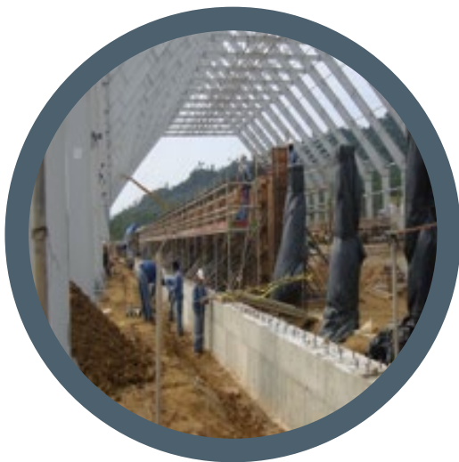
PAU – Fundaciones internas Depósitos de urea
