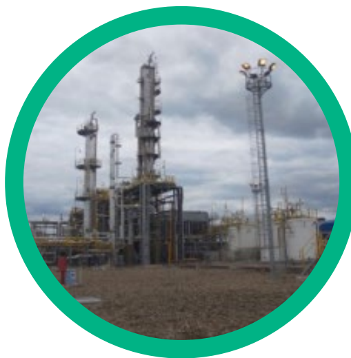
PSL Rio Grande – Columnas de Proceso
