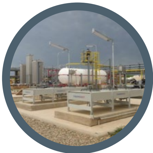
Planta GNL – Evaporadores y compresores de alta y baja presión
