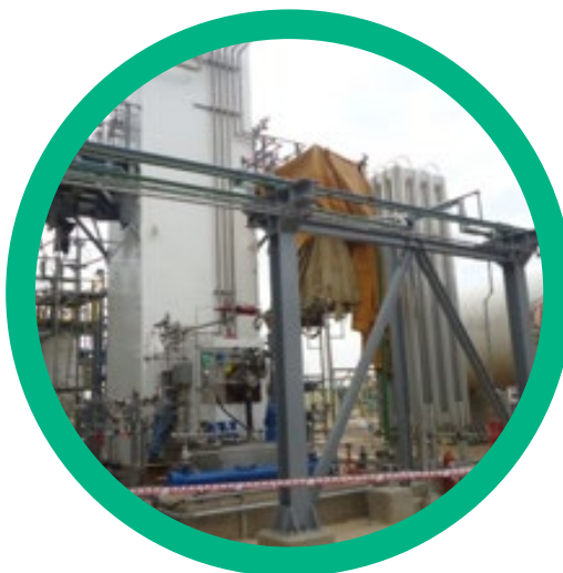
Planta GNL – Expansor y Evaporadores
