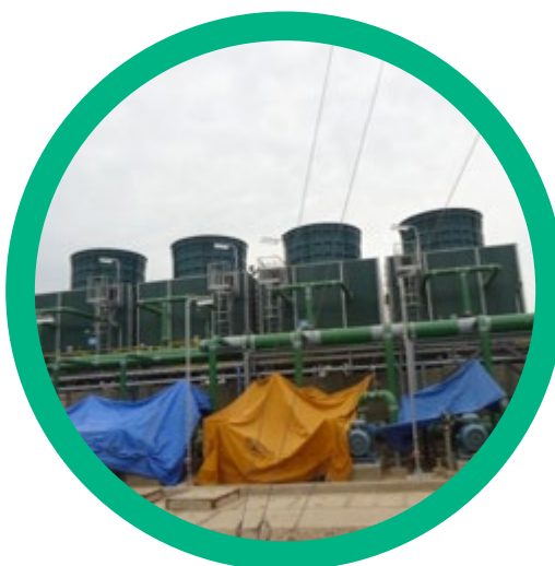
Planta GNL – Torres de Refrigeración
