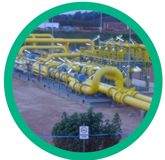
PSL Carlos Villegas – Entrada y Salida de Gas Residual
