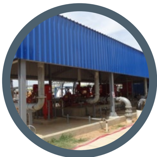
Planta GNL – Bombas Sistema Contra Incendio
