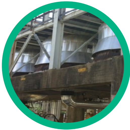
3R-1301; 3R-1302; 3R-1303; 3R-1304 Proceso de Regeneración — Reactores
