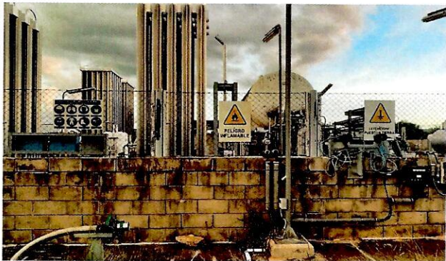
IMAGEN N°5: ESTACIÓN DE REGASIFICACIÓN SAN JOSE DE CHIQUITOS
