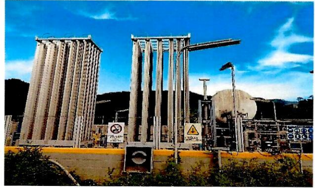
IMAGEN N°2: ESTACIÓN DE REGASIFICACIÓN GUANAY
